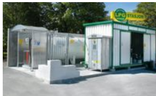
station de remplissage
